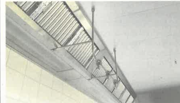
Die Feuerlöschbrücke vor den Fettabseidern. Foto: Reven
